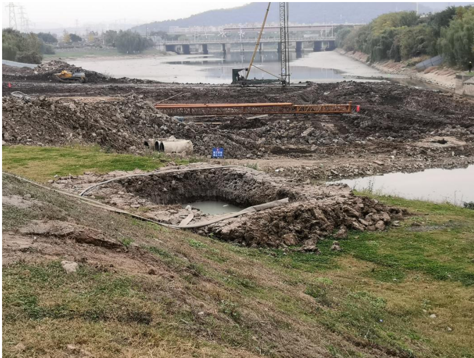
图 5.2.1-2 施工现场基坑排水沉淀池
