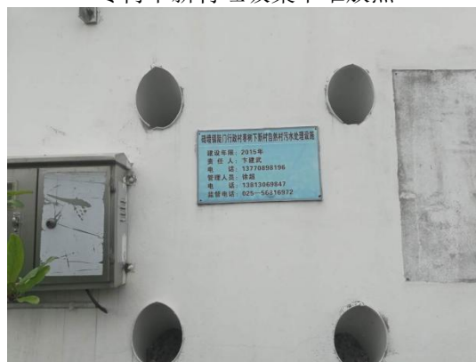
枣树下新村污水处理设施
