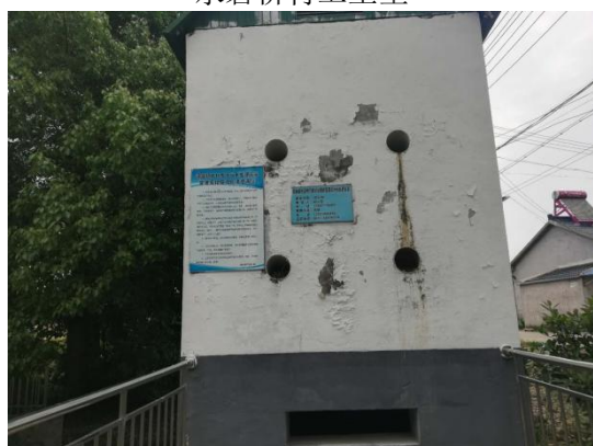
水碧桥村生活污水处理设施
